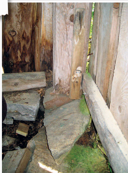
Detalj syd-vestre hjørne 9. juni, utrast mur og fuktskader
