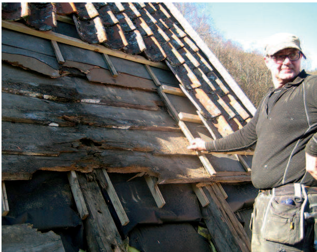
Reidar Kloster avdekket store råteskader i taket over kjøkkenet.
